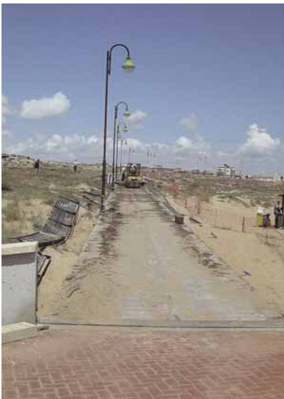
ERSTATTES: Treplankene langs La Mata skal tas bort og erstattes med betong.
