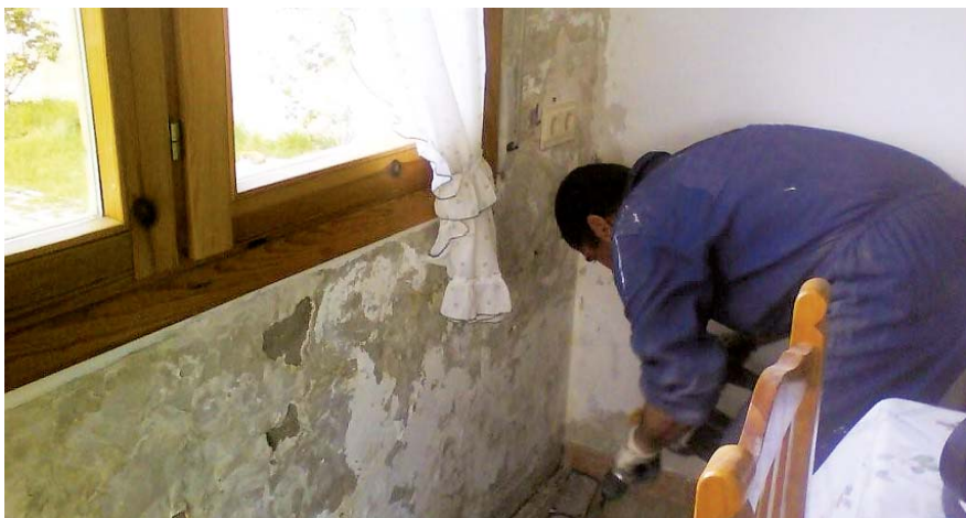
HELSEFARLIG: Fukt og sopp kan i verste fall medføre alvorlige helseplager som astma og allergi. Problemene er svært utbredt i det fuktige klimaet langs middelhavet og på Costa Blanca.
