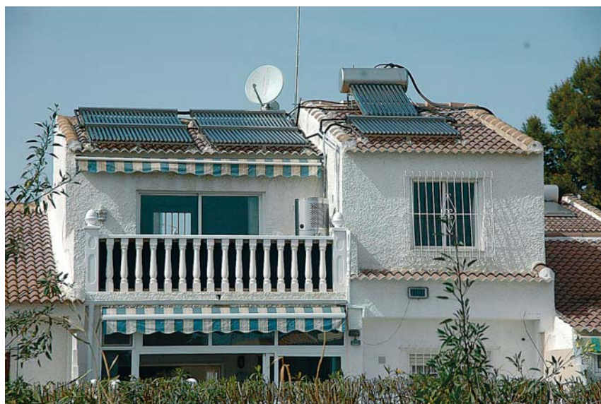
USYNLIG FRA HUSET ELLER GATEN: Slik ser det ut på taket til ekteparet Pagh. Dette er en relativt omfattende installasjon. For mange vil det være nok med ett "panel" eksempelvis for å varme opp varmtvannet i huset og svømmebassenget. Rør og kabler kan "gjemmes bort" ved å legges inn i vegger, sjakter m.m.
