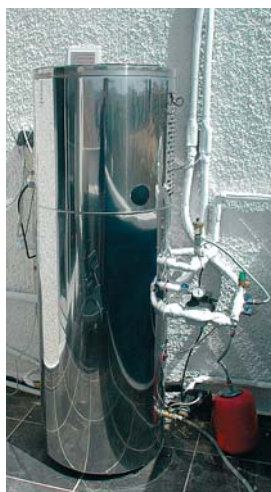
KOMBIREDER: Denne varmvannsberederen sørger for at ekteparet Pagh alltid har god innnetemperatur. Når det er lite sol, får den hjelp av en 55 watts varmepumpe.
