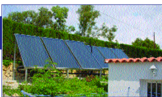
Solpanel kan også innstalleres i hagen eller annet sted på tomten.
