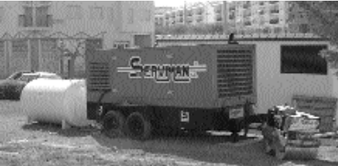
For å få strøm til bygget under åpningen måtte man ty til dette mobile strømaggregatet.
