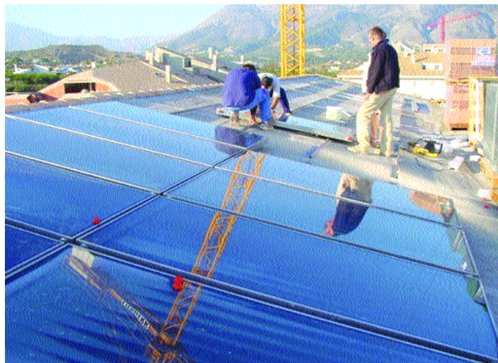
Solpanel på taket
