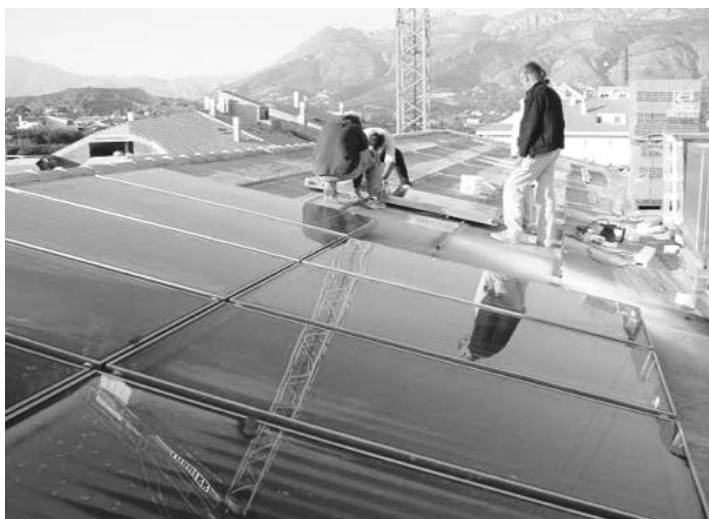
Solpanel på taket
